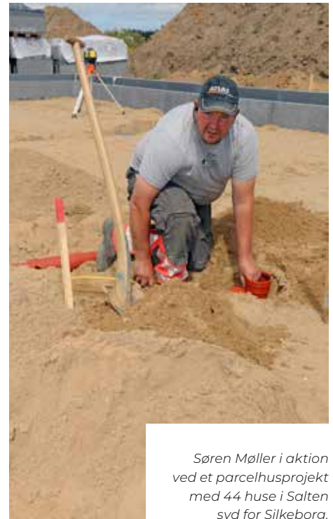
Skiltet med Entreprenørfirmaet Søren Møller er på plads ved udstykningen ved Salten ved Silkeborg i hvert fald til 2024. Her har entreprenøren og kloakmesteren godt selskab af junior, Marcus.
