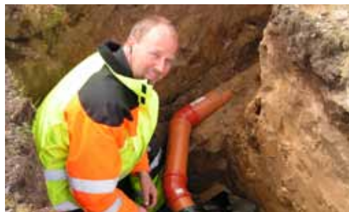
Formanden for Danske Kloakmestre, Verner H. Kristiansen, forbinder røret fra sandfangeren med regnvandstunnelen.
